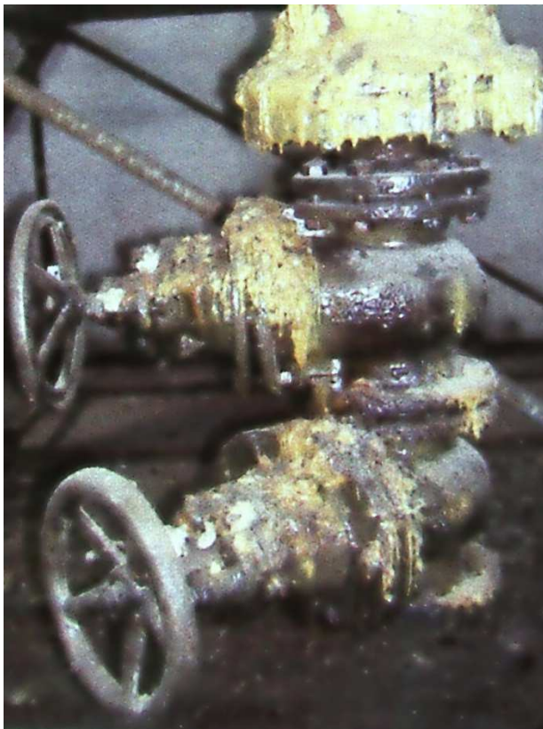
Povrch před čištěním
